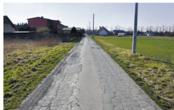
W budżecie na ten rok zostały zabezpieczone pieniądze na remont ulicy Rybitwy w Rajsku. Fot. LCH
